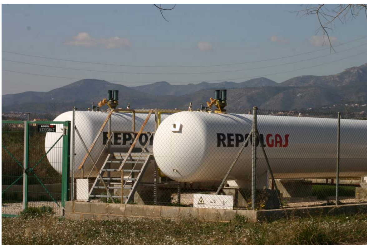
Foto n°96. Dipòsits de gas – probablement propà – situats a tocar del límit est del casc urbà de Banyeres.
